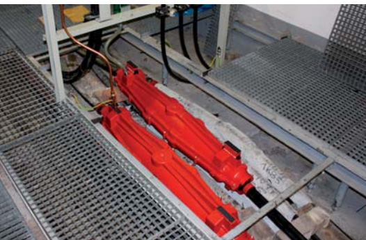
Öl-Nachfüllmuffen in Schaltanlage
